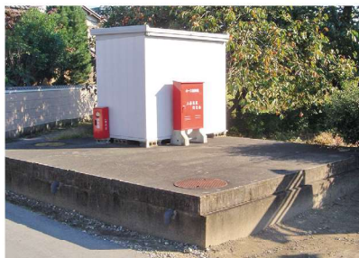
半地下式防火水槽
